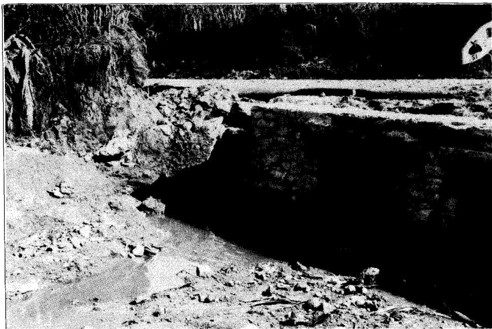
Estat del pont de Can Codina després de l'aiguat
