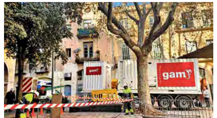
PLAÇA DE LES PATATES. S'hi va instal·lar un grup electrogen
