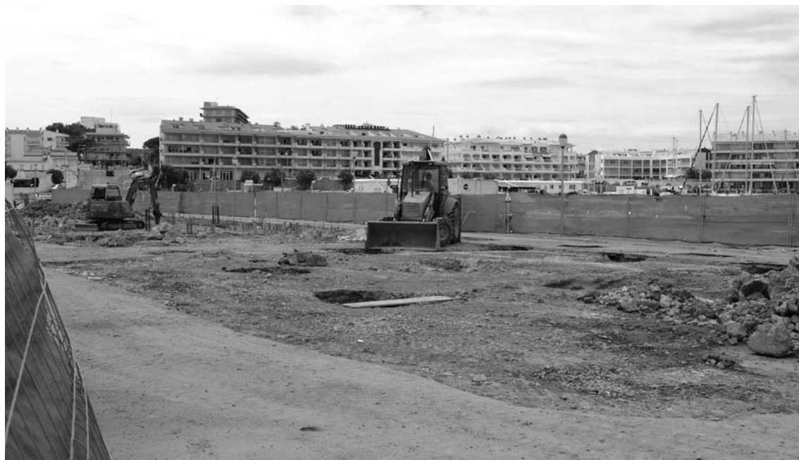
ALS TERRENYS DE L'ANTIGA LLOTJA DE PEIX. En aquests moments, ja s'ha acabat la fonamentació del nou edifici
