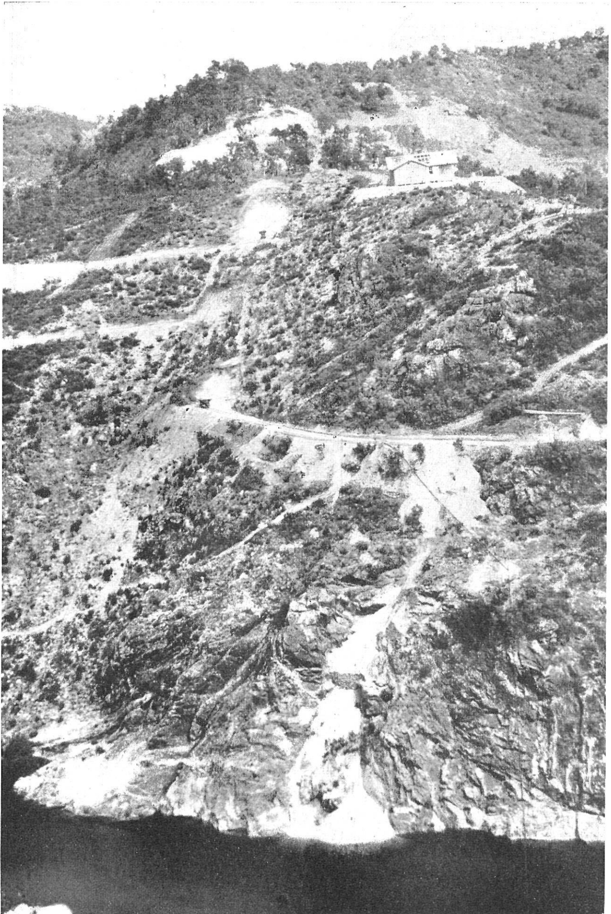
Margen izquierda del Muga con las excavaciones del estribo izquierdo de la presa de Buadella ya iniciadas.
