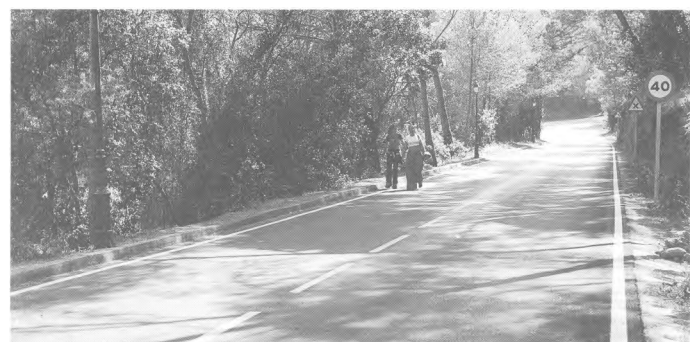
Arranjament de la carretera de Sa Tuna a Cap sa Sal (Diputació de Girona).
