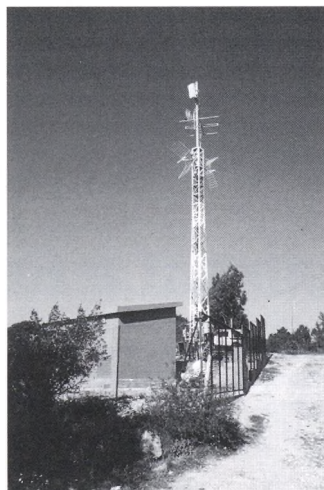
Caseta del nou reemissor Font de la Salut.
