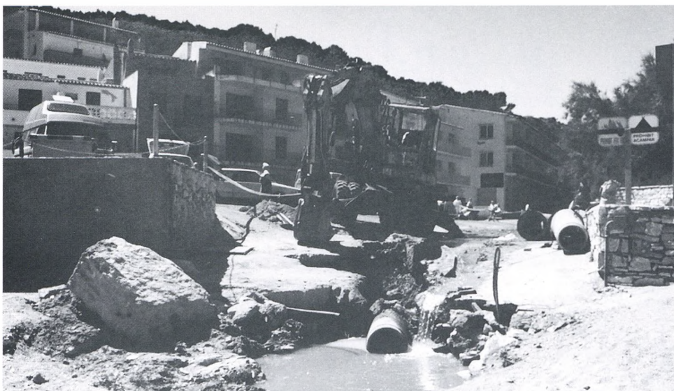
Canalització aigües pluvianes de la riera de Sa Riera.
