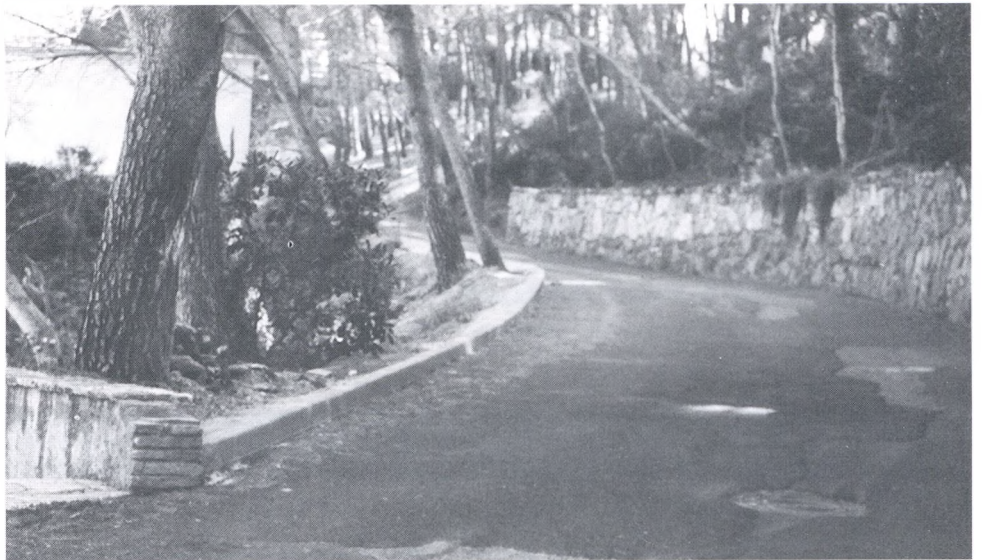
Reparació d'un tram de la carretera de Sa Riera a Sa Tuna.
