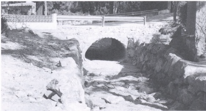
Riera de Salt Ses Eugues. S'han realitzat treballs de protecció de la riera i s'ha construït un nou pont. (Març 1993)
