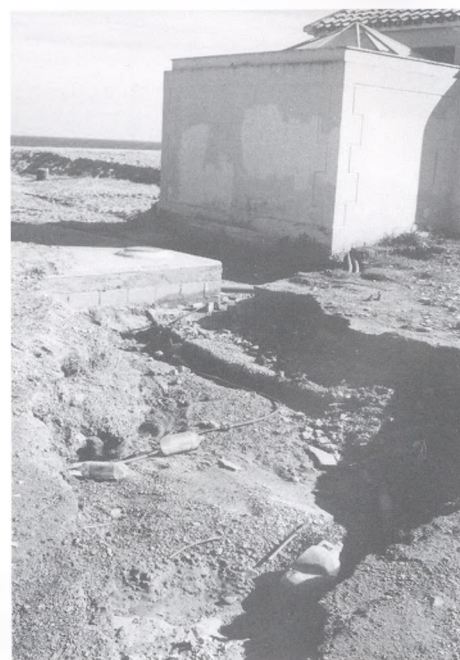
Com a conseqüència de les pluges, també fou necessari l'apuntament de la caseta de banys de la platja del Racó.
