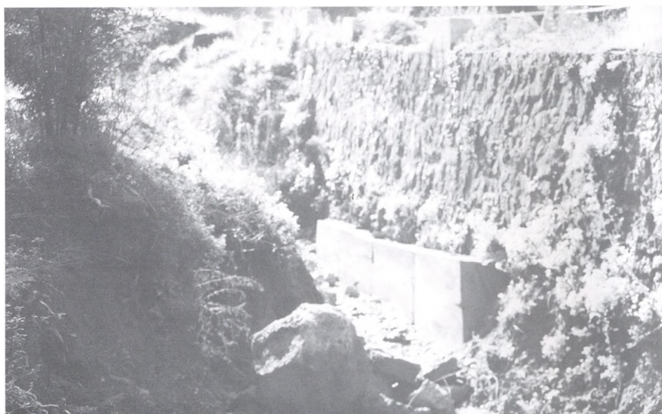
Les intenses precipitacions de pluja del passat mes d'octubre van provocar un descalçament de la carretera de Sa Riera, que obligà a posar un reforç, tal com podem observar a la fotografia.
