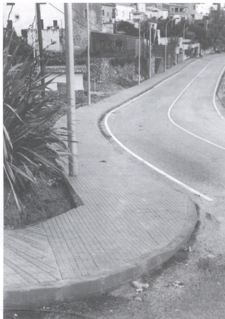
S'han acabat les obres del tram de la carretera de circumval·lació amb la instal·lació de fanals i la construcció definitiva de les voreres.
