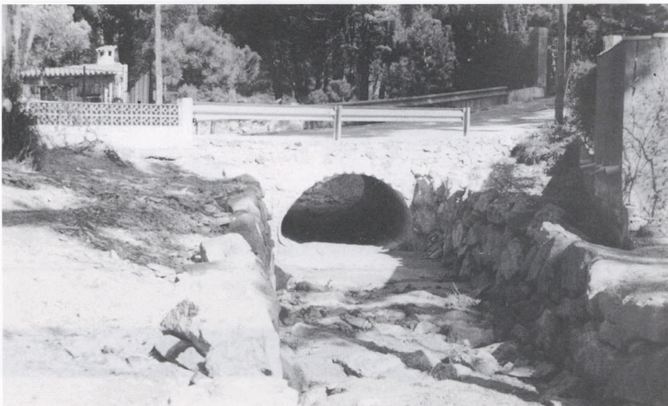
Riera de Salt Ses Eugues. S'han realitzat treballs de protecció de la riera i s'ha construït un nou pont.
