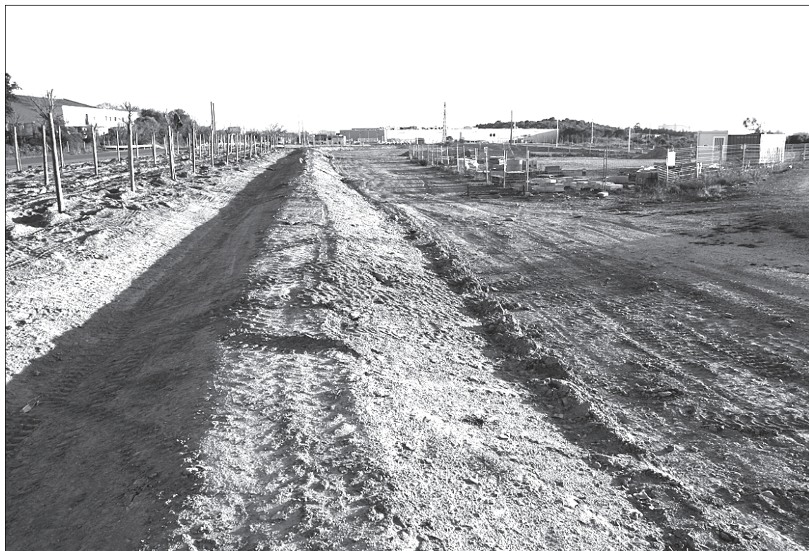
Les obres a la zona industrial de Roses estan a punt d'acabar
