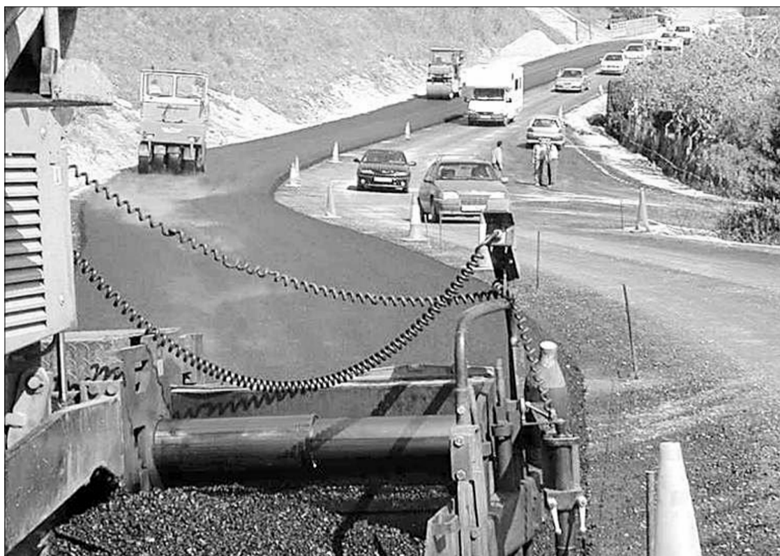
Una imatge de les obres de condicionament de la N-260, concretament al tram de Colera
