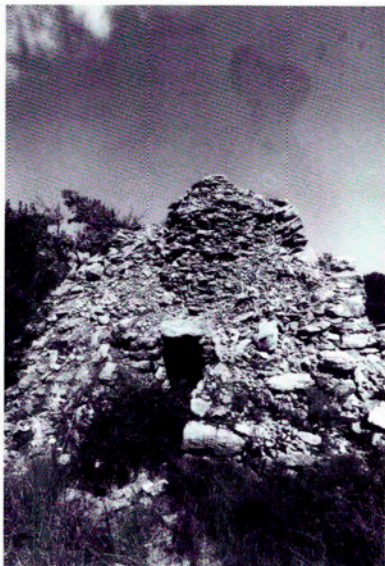
Barraca molt degradada del paratge de la Garriga.
