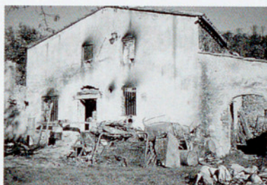
Can Masó, a Viabrea. Una masia afectada per l'incendi.
