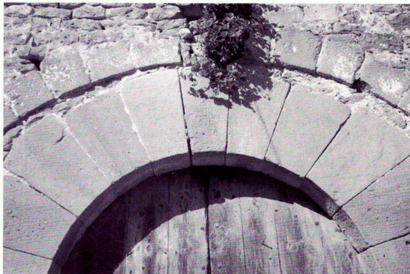
Portalada de la Perpinyana, amb signes evidents de deteriorament de la pedra a causa del salpàs.
