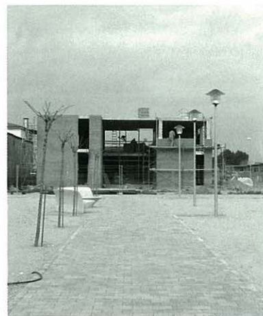
L'any 2002 es va començar la construcció de la nova Casa Consistorial, que es preveu acabar durant el 2004.
