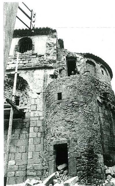
Enderrocament de la torre i escala del campanar, en la restauració del 1971.
