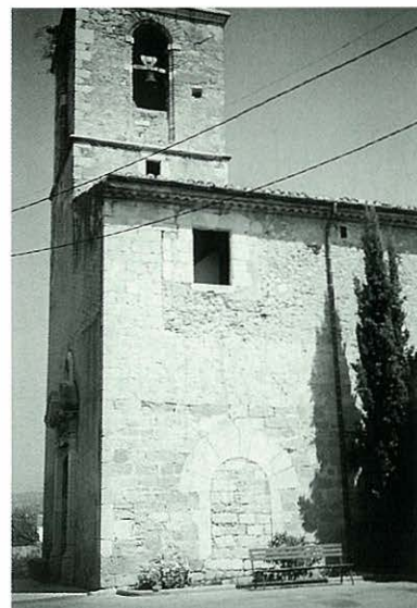
Façana de migdia de l'església de Sant Cebrià de Vilafant. S'aprecien perfectament les tres etapes constructives a partir del primer temple romànic del segle XII.
