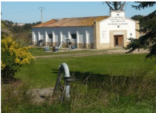
L'estació de tractament, a Torrent Foto: A.V.
