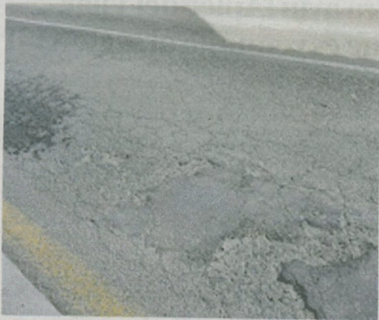
Un tros de via amb l'asfalt malmès.
