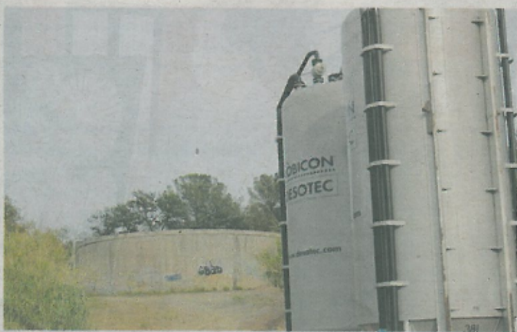
El dipòsit actual en mal estat del puig Negre.
