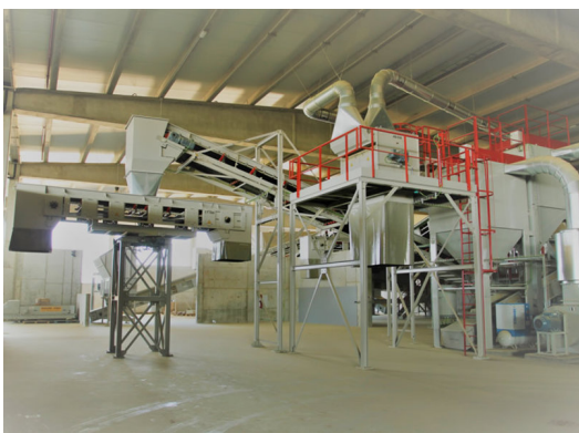
Planta de refinament secundari dins la planta de compostatge del Centre de Tractament de Residus de l'Alt Empordà CTR ALT EMPORDÀ.
