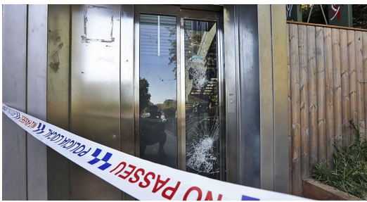
L'ascensor de Vista Alegre amb el vidre trencat, en una imatge d'arxiu
