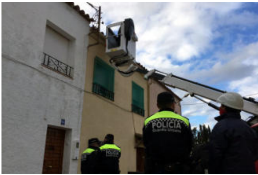
Figueres encarrega una auditoria per saber l'estat de línies elèctriques
