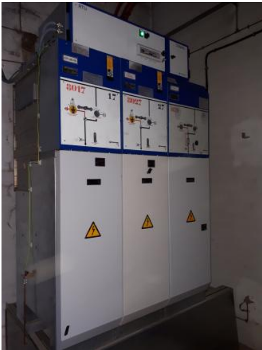
Un centre de transformació
