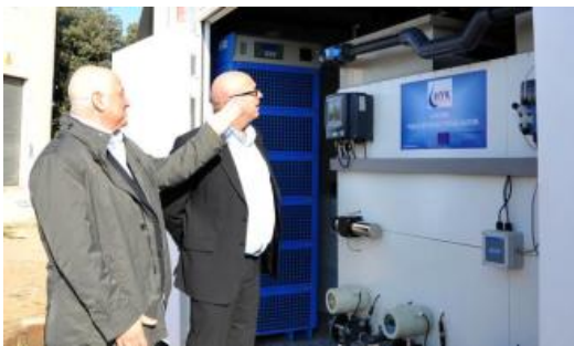
La planta que s'ha posat en marxa a Borrassà.
