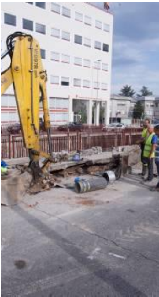
Tallen una avinguda de Girona per una fuga d'aigua
