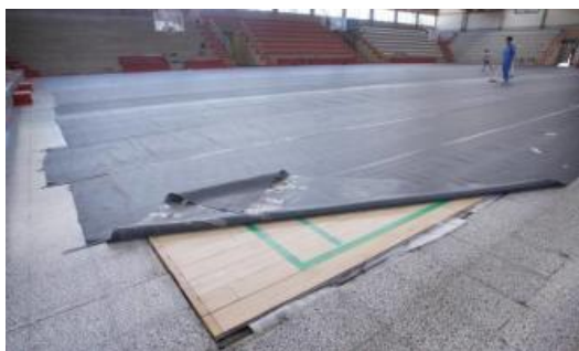
El parquet del pavelló de Palau, malmès.
