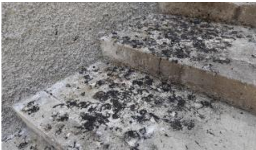
Acumulació d'orins i defecacions a les escales de la Llebre de Girona
