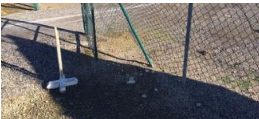
La reixa del camp de futbol que va quedar malmesa
