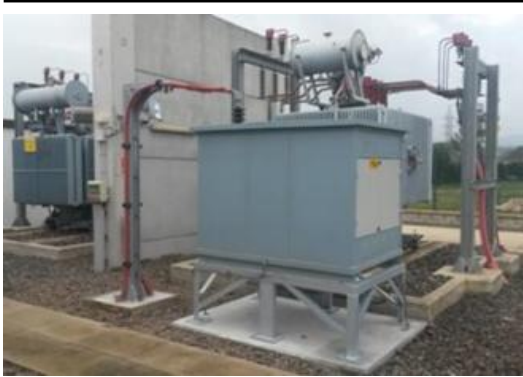
La subestació de l'Empordanet.
