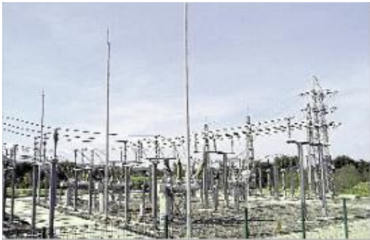
La instal·lació, que dona servei a 42.000 abonats.
