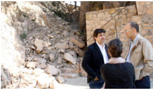
L'alcalde, davant del desprendiment de l'accés de la Cala d'Aigua Xelida |
