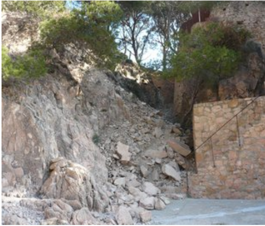
El desprendiment ha afectat un bon tram de les escales d'accés a la cala d'Aigua Xelida. Foto: A.V.
