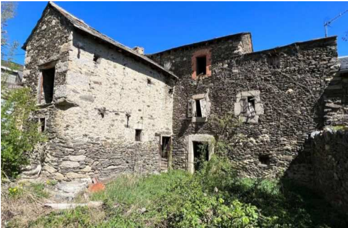
Un habitatge de Guils de Cerdanya en procés de rehabilitació per destinar-lo a habitatge social./M.F.
