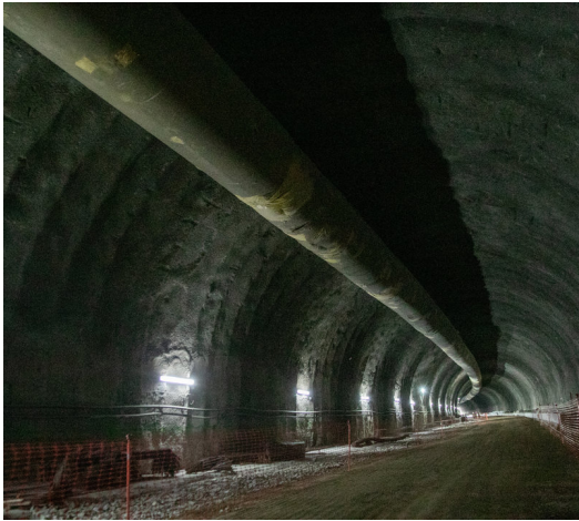
El túnel de la variant d'Anglès, en una imatge d'arxiu, s'obrirà aquest novembre Q. PUIG.
