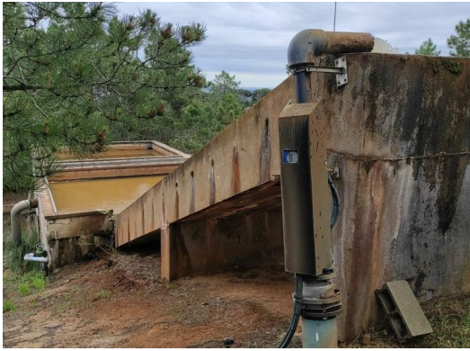
Un dels pous d'aigua de Residencial Parc CEDIDA PER L'AJUNTAMENT DE MAÇANET DE LA SELVA.
