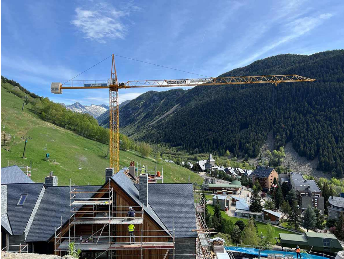
Construcció de nous habitatges per al turisme d'hivern a la Val d'Aran (Foto: arxiu ACN).
