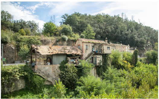
L'antiga estació de tren, vista des de la part posterior, on es veu clarament el deteriorament QUIM PUIG.
