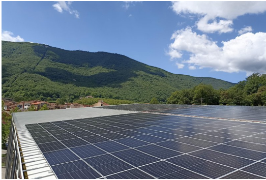
Instal·lació fotovoltaica a Sant Feliu de Pallarols.
