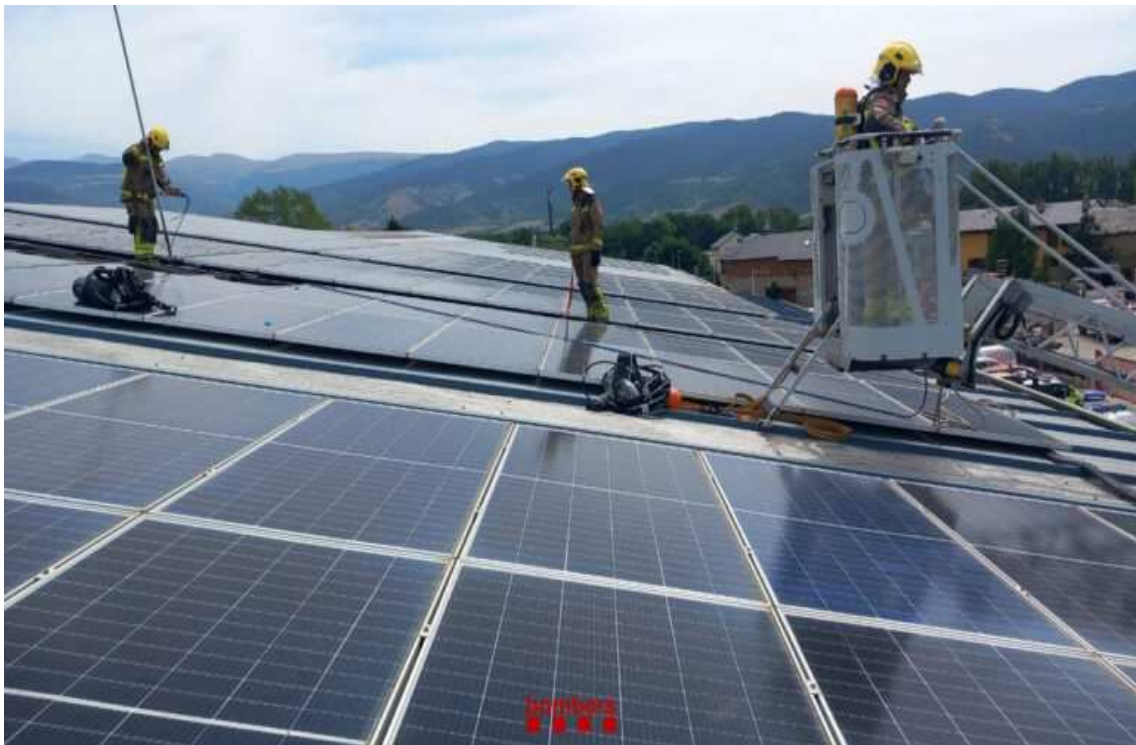
Plaques fotovoltaïques afectades per l'incendi./Bombers.
