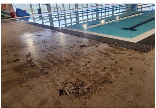
L'aigua va entrar a les instal·lacions de la piscina coberta AJUNTAMENT DE CASSÀ.
