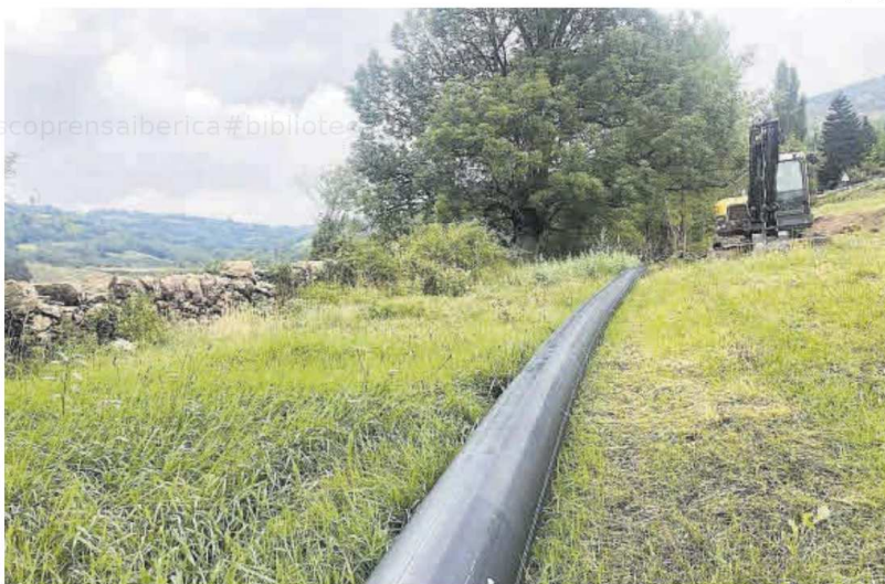
Un dels trams en obres del Rec Gros de Prullans amb les canonades que s'hi instal·len
