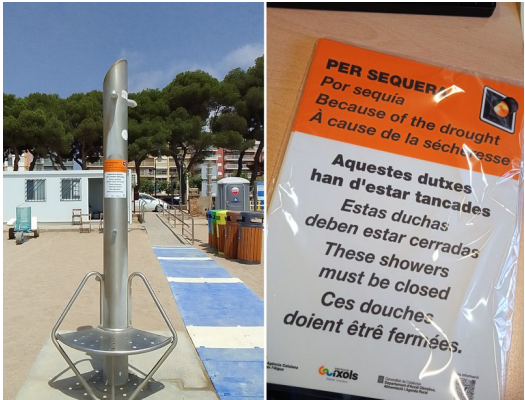
Una de les dutxes sense aigua i amb l'adhesiu municipal EPA.
