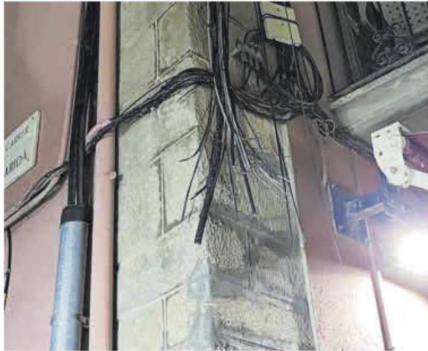
Els cables de fibra òptica tallats de la plaça Santa Maria de Puigcerdà
