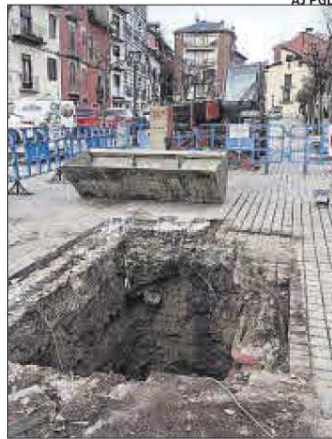
El forat de l'entrada al túnel
