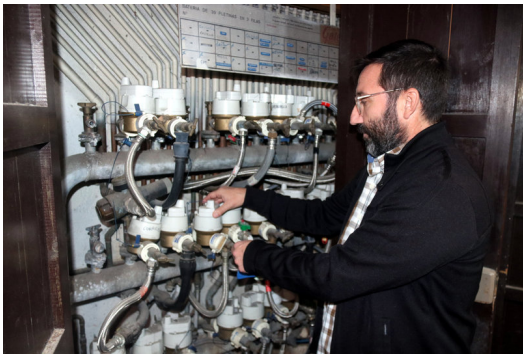
Un tècnic de la companyia revisa comptadors a Begur. XAVIER PI (ACN).
