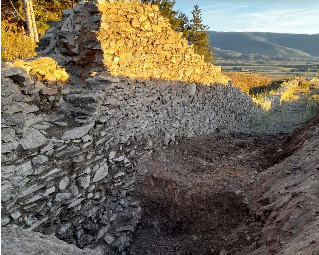
Comença una nova fase d'excavacions i de consolidació al castell de Llívia / llivia.org
